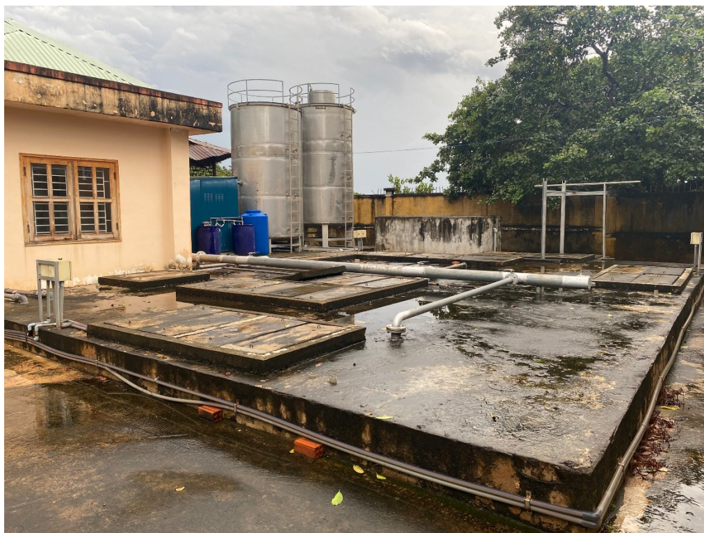
Hình 3. 5: Hình ảnh hiện trạng trạm xử lý nước thải tập trung của Trung tâm Y tế khu vực Phước Long công suất 200 m 3 /ngày.đêm
